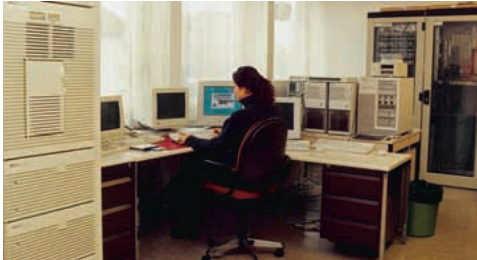
Der heutige Systemraum für das PC-Netzwerk.
