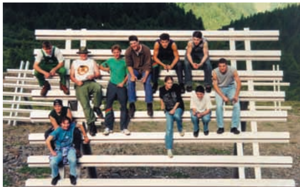
Lehrlingslager 1996: Wohlverdiente Pause hoch über dem Rhonetal in Fiesch VS. Die Rapid-Lehrlinge justieren und reparieren die Lawinerverbauungen.
